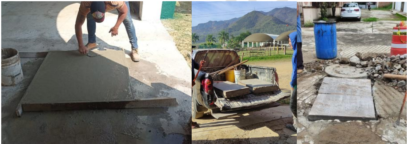
TAPAS DE REGISTROS PLUVIALES Y SANITARIOS
